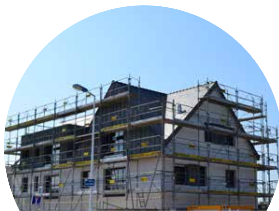
8 logements sont en cours de réalisation au 10 rue de Quéhello, à l'angle de la rue des Trois Pierres
